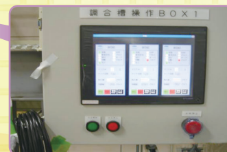
現場制御・監視盤
