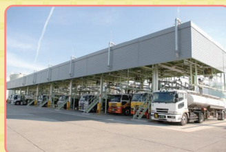
ローリー出荷設備
