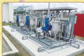
燃料添加設備
