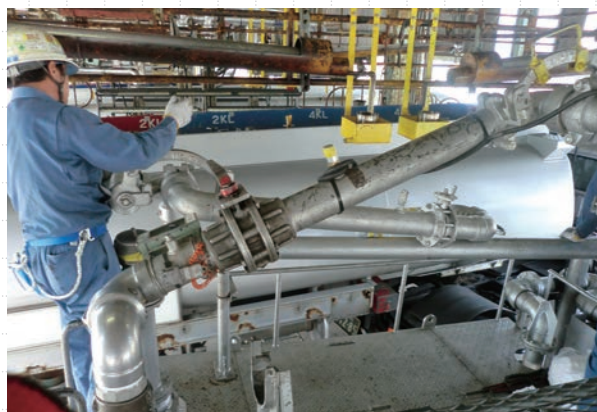
【ローリー出荷設備 流量計器差試験】
