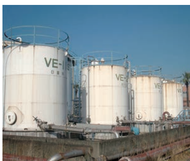
【(左から)重油、ガソリン、灯油、軽油のバッファタンク】
